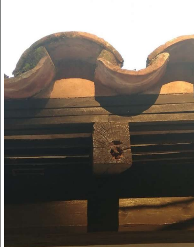
Se observa la presencia de termitas en los tirantes de madera del techo en la galería frontal.
