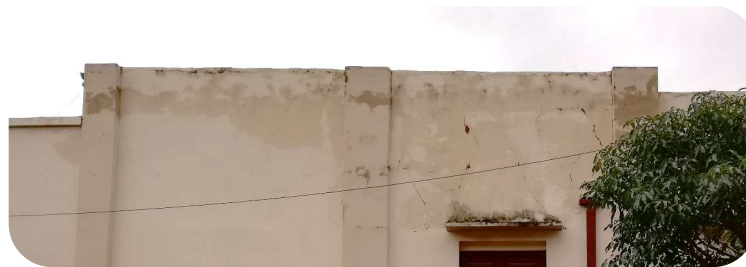
En los remates de las fachadas se observan manchas de humedad y descaramientos del revoque.
