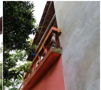
En este muro lateral se evidencian las diferentes etapas de construcción, debido a la pérdida de verticalidad del mismo.
