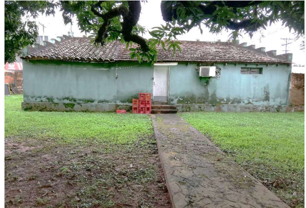
Fachada posterior, donde se observa la caída del techo hacia el patio interior y la presencia de humedad por capilaridad en el muro.
