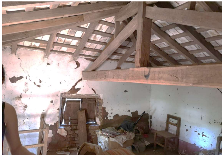
Planta alta donde se observa la cabriada que posibilita las diferentes caídas del techo. Además, se visualiza el estado de conservación de la mayoría de los muros de la vivienda: desprendimientos del revoque y manchas de humedad.
