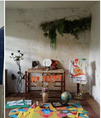
Muro de la capilla afectado por la humedad, probablemente proveniente de filtraciones de la losa superior.
