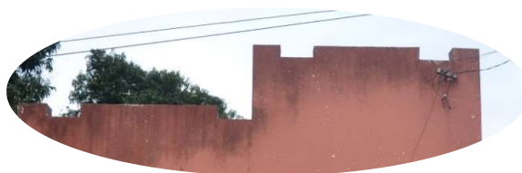
Detalles del escalonamiento en el coronamiento del muro de la fachada. En la fachada se observan además manchas de humedad y desprendimientos del revoque.
