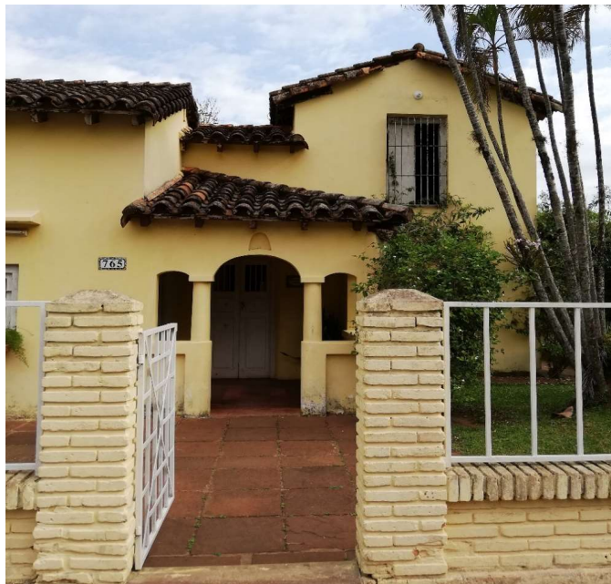
Porche de acceso a la vivienda. En la base del muro se observa la presencia de humedad y el consecuente desprendimiento de revoque.
