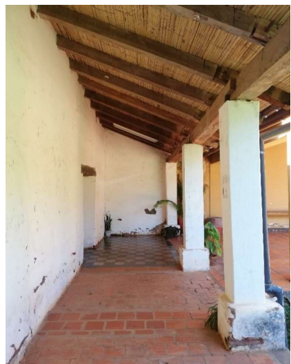
Pilares con desprendimientos del revoco y manchas de humedad.
