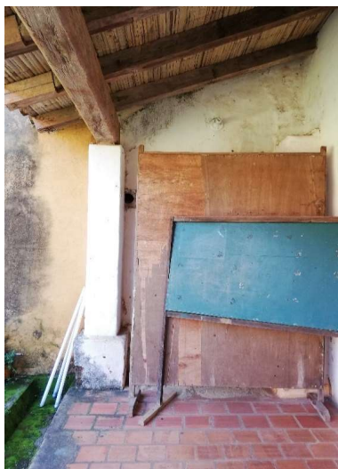
En gran parte de la edificación, se observa el desprendimiento del revoco en los muros.
