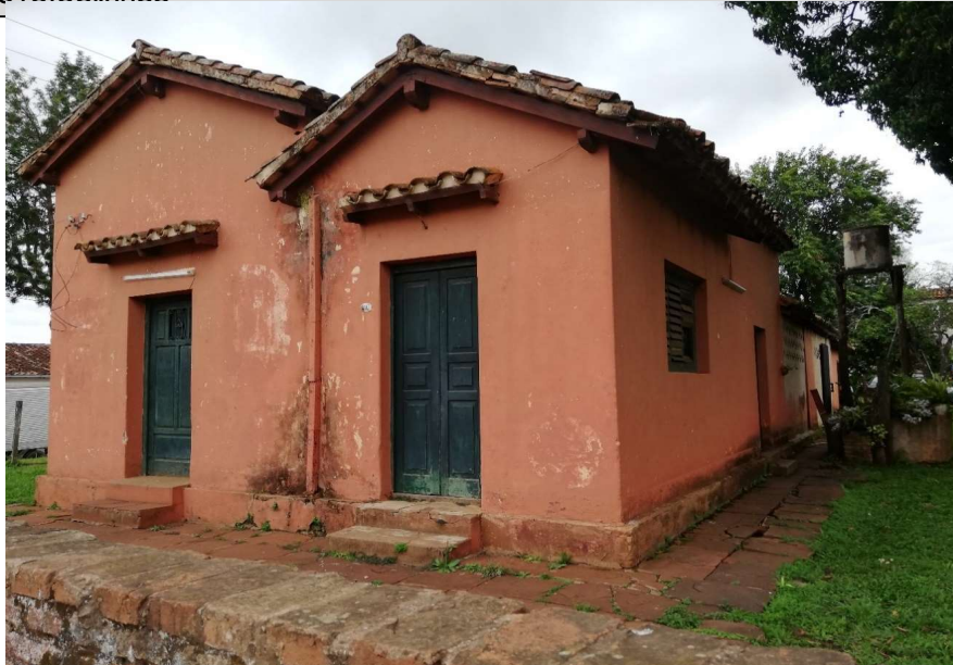
Fachada de la vivienda. Se observan los elementos de protección sobre las aberturas, característico del Chalet. Se observa además la humedad puntual ocasionada por la filtración de aguas de la
