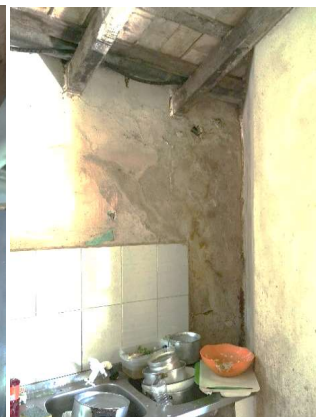
Sector de cocina con presencia de humedad en los muros.
