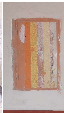
En el muro antiguo de la edificación del 52' se observan testigos pictóricos.
