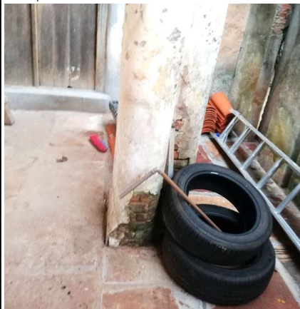
Detalle del pilar: presencia de humedad y desprendimiento del revoque en la base del mismo.
