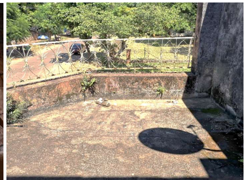
Azotea en planta alta con desagües pluviales obstruidos que dan paso a la acumulación de aguas y la consecuente filtración de las mismas al interior de la edificación.
