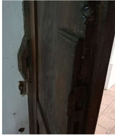
Pequeños desprendimientos del revoque y aberturas con leves erosiones por la pérdida superficial del material.
