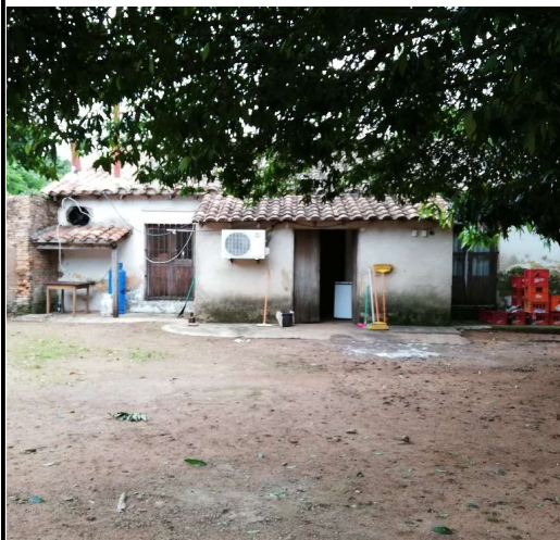
Vista del área de servicio situado en la parte posterior del inmueble. El muro de este sector se encuentra afectado por la humedad capilar.
