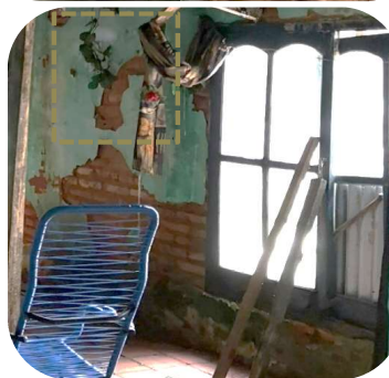
Desprendimiento de revoque prominente en los muros y humedad capilar. En la imagen se observa además la presencia de vegetación en el muro.
