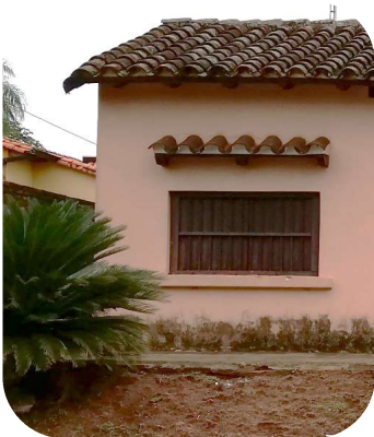
Detalles de aleros de tejas sobre las aberturas. En la base se observa la presencia de moho debido a la humedad, al igual que en el techo.
