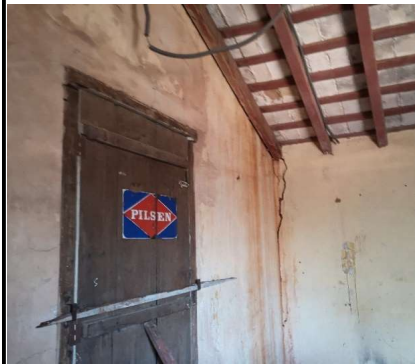
Habitación de la planta alta. En el muro se observan grietas estructurales y manchas.
