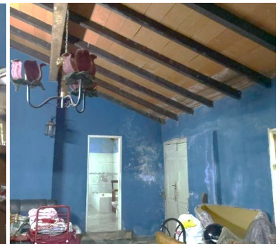
En el muro que linda con la edificación posterior se observa la presencia de humedad, probablemente ocasionada por la confluencia de las caídas de techo.
