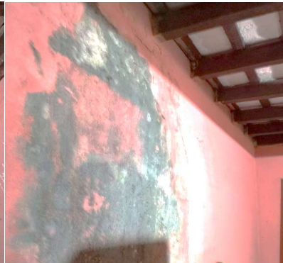
Presencia de humedad en el muro que linda con el depósito con sótano.
