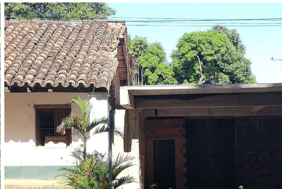
Foto tomada en el 2018. Se observa la construcción nueva, contigua al inmueble, situada en la Esquina, que cumplirá una función mixta (habitacional-comercial). En la imagen se observa como la construcción nueva afectó a la cubierta superior de la casa de indios.
