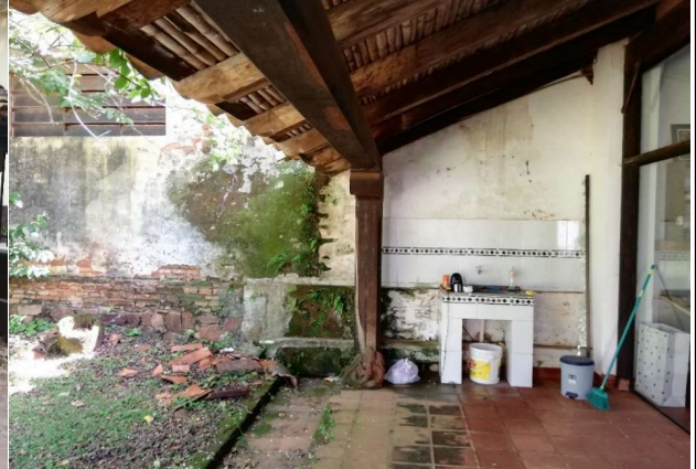
En la fotografía se observan las patologías que surgieron como consecuencia de las instalaciones pluviales mal hechas: el equipo de acondicionamiento de aire desagüa en el interior de la galería y el canalón no cuenta con la profundidad necesaria, lo que provoca la aparición de humedad en el muro, en el pilar de madera y en el solado.
