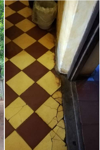
Desprendimiento del piso original calcáreo en la conexión con el área de servicio.
