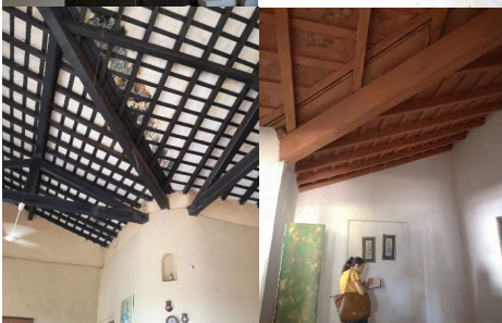
Vistas de la estructura del techo del bloque de la esquina. Se aprecia la humedad producida por las filtraciones.
