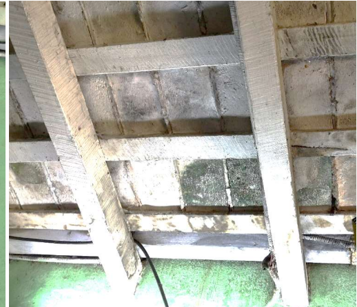
Techo perteneciente a la edificación posterior, conformado por tirantes, alfajías y tejuelitas, y que cuenta con la presencia de humedad debido a filtraciones.
