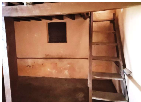
Vista del sótano. Se aprecia la presencia de humedad en los muros.
