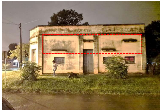
Foto actual de la vivienda, donde se aprecia el detalle de las molduras en la fachada a diferentes alturas. Además se destaca la presencia de hongos en la misma.
