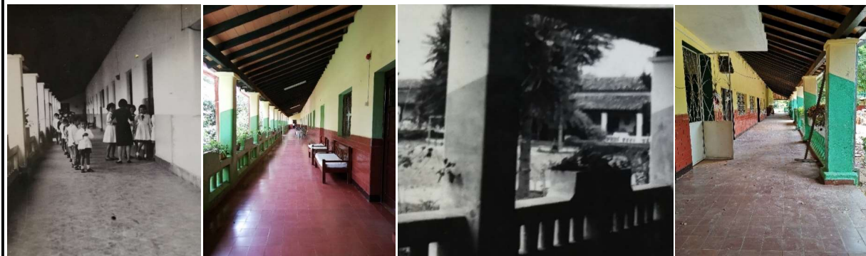
Fotografías de las galerías de los bloques antiguos. En las primeras fotografías se puede apreciar la sustitución del solado original.
