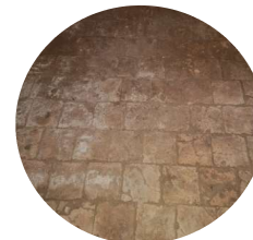
Solado original. En ciertos sectores de la edificación presenta erosión y con manchas.
