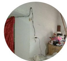
Conexiones eléctricas sueltas que representan un riesgo para los residentes y para el inmueble.
