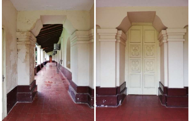
Vistas de la galería lateral y del acceso principal de la edificación antes de la restauración. Se observaba la presencia de humedad, manchas y descaramiento en los muros.
