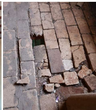
Pisos originales, con desprendimiento y rotura de material.
