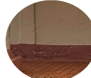
Decoloración y desprendimiento de revoque en gran parte de los muros de fachada.
