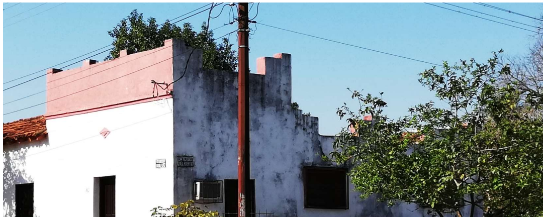
Detalle del escalonamiento en los coronamientos de las fachadas. El escalonamiento lateral esconde la caída del techo hacia el interior de la edificación. Se observan manchas de humedad y presencia de vegetación en el muro.
