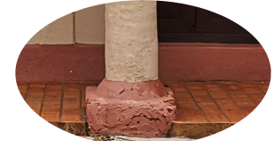
Desprendimiento de material en la base de los pilares.
