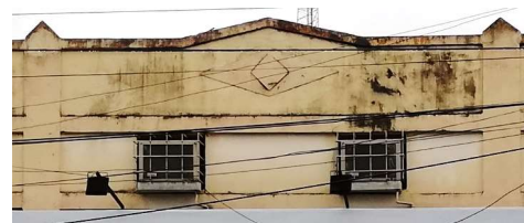
Presencia de humedad en el coronamiento de fachada.
