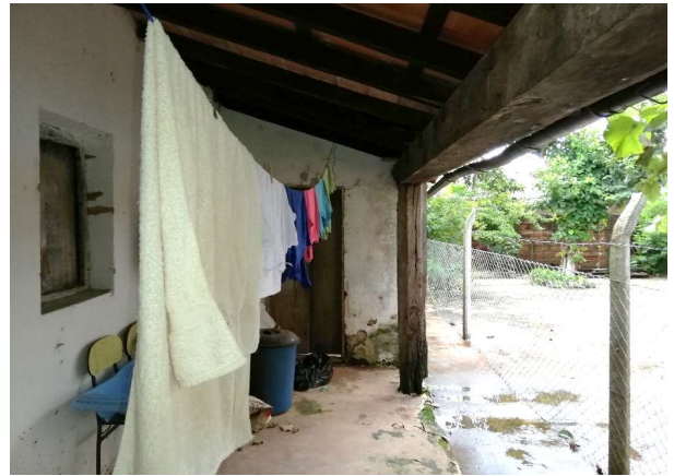
Galería interior de la vivienda. Se puede apreciar el mal estado en el que se encuentran los muros y pilares.
