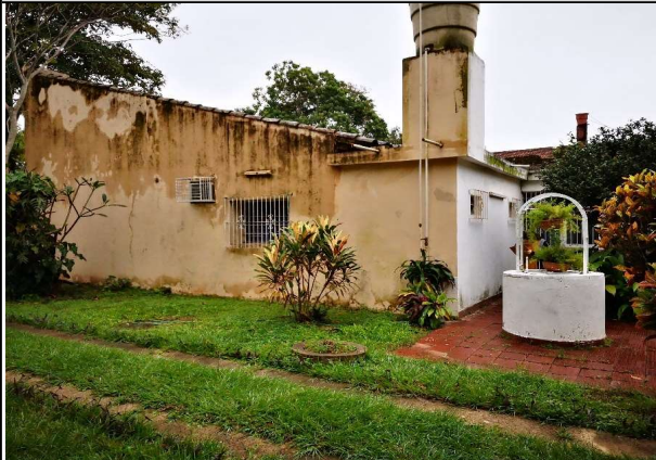
Fachada lateral de la edificación donde se aprecian las caídas del techo y las uniones entre los bloques de distintas etapas. En el muro se presentan manchas de humedad.
