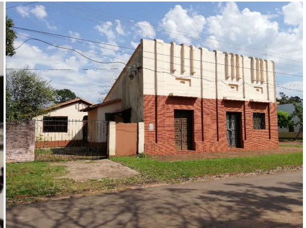
Se aprecian los 2 bloques de la vivienda: sobre la línea municipal, el principal, y retirado de la misma, el de servicio; y la diferencia de escala entre ambos. Además, es posible apreciar como el sanitario adicionado desvirtúa la lectura conjunta de las fachadas.
