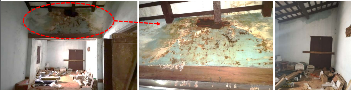
Vano de unión entre la edificación antigua y la posterior, donde se ubicaba la galería posterior que fue eliminada. En la parte superior se observa la presencia de humedad y hongo en el muro, por posibles filtraciones en la cubierta.
