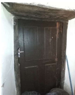
Abertura de la época. Presencia de leves erosiones y descascaramientos.
