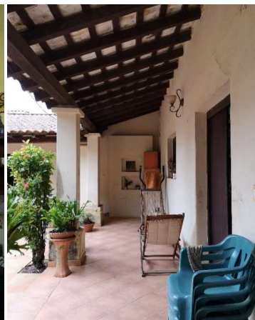
Galería interior. En la imagen se ve el techo de tirantes, alfájas y tejuelitas. En estas últimas se observan manchas de humedad.
