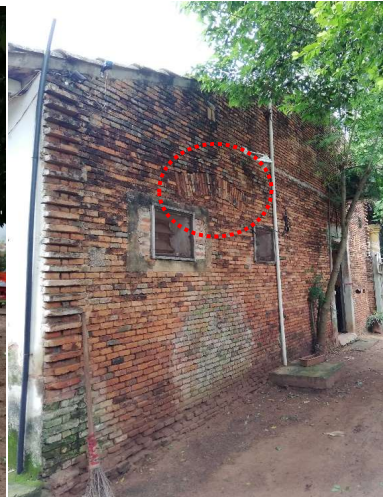
Fachada lateral de tendencia estilística arts and crafts, donde se ve un arco de abertura que posteriormente fue cerrada. En la imagen se observa la presencia de humedad por capilaridad y filtraciones.
