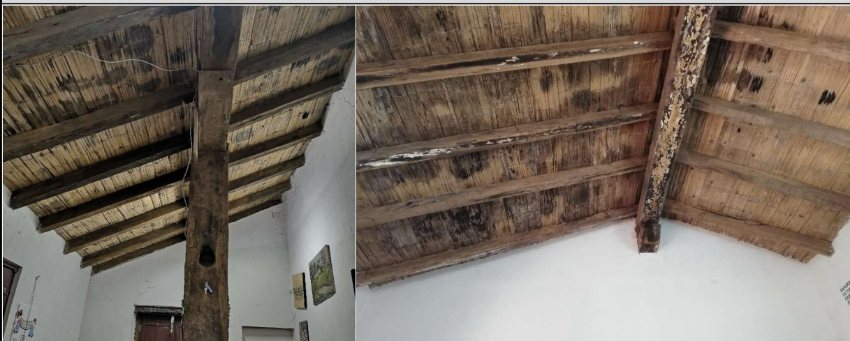
En las imágenes se observa el estado del maderamen, que presenta manchas por humedad, desgastes y pudriciones.
