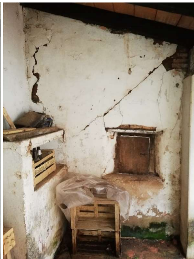
Fotografía del depósito semicubierto. Fisuras, desprendimiento del revoque y manchas de humedad en los muros.
