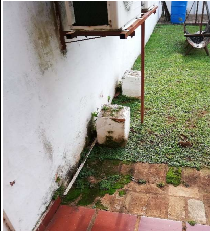
Humedad puntual ocasionada por el compresor del aire acondicionado ubicado en el muro lindero.
