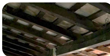
Humedad y hongos presentes en las tejuelitas de la cubierta de la edificación posterior. Es importante identificar igualmente las patologías de este sector por afectar directamente a la edificación patrimonial al estar adosada a la misma.
