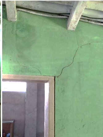
Grietas estructurales, probablemente como consecuencia de la incorporación y apoyo del techo de la edificación posterior sobre el muro.
