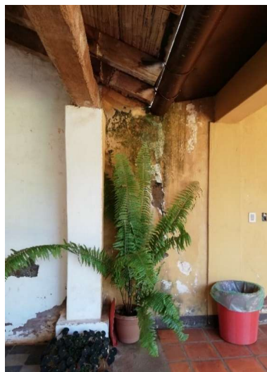
Unión entre el volúmen antiguo y el nuevo, que da paso a la humedad por filtraciones.
