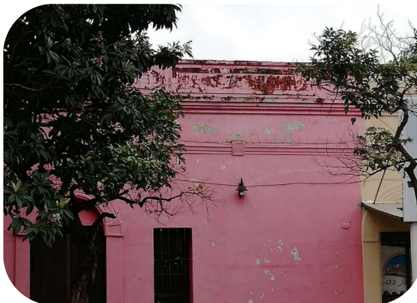
En la fachada sobre la calle Mariscal López se evidencian manchas y hongos, y desprendimiento del revoco.
