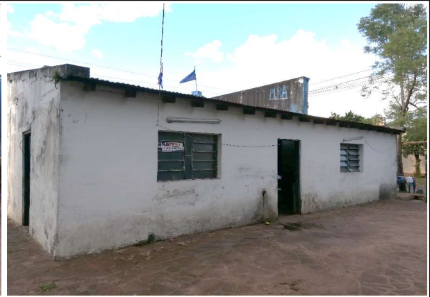
Vista desde el patio interior, donde se aprecia el techo de chapa y los muros con presencia de humedad.
