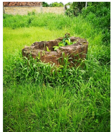
Vista del aljibe ubicado en el patio posterior de la vivienda. Presenta pérdida de material y vegetación.
