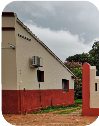
Fachada lateral, donde se visualiza la caída del techo en dirección al patio interior.
