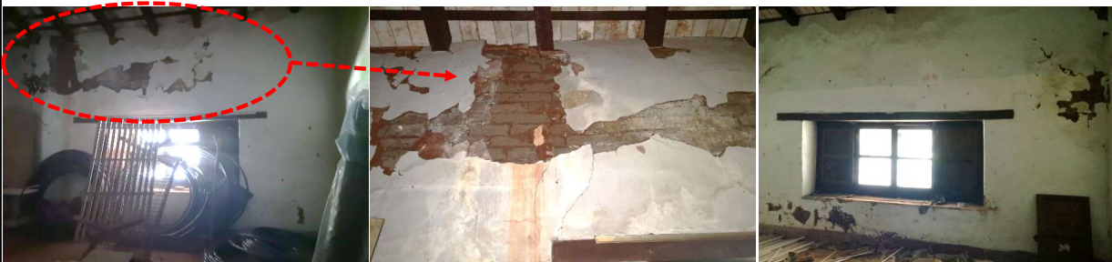
El desprendimiento del revoco evidencia la materialidad de los muros de fachada, ladrillos de tierra o adobe. Las fisuras observadas son superficiales. Ambas patologías se presentan en todas las habitaciones de la edificación.
