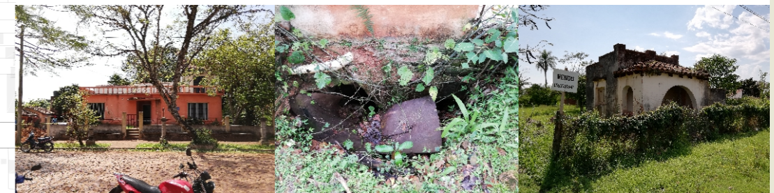
Edificación N° 85, de la Fundación Jesuitas, en mal estado de conservación, principalmente por los asentamientos y peligros estructurales.
