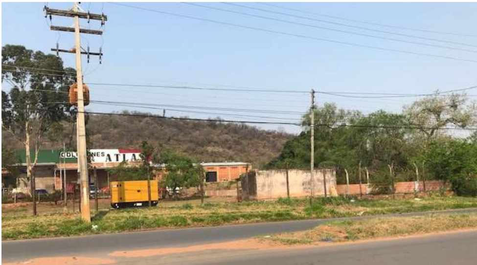
Tendido Eléctrico sobre Avd. Caaguazú.
