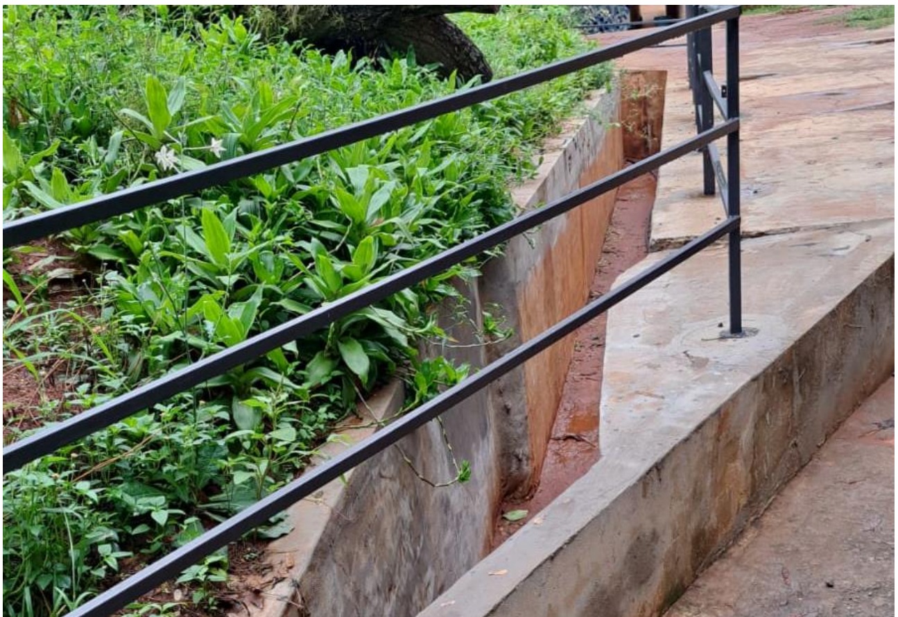
Fig. 171 Canalización pluvial a cielo abierto
